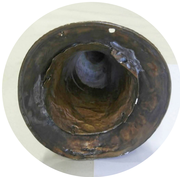
Obr. 13: Pohled dovnitř korpusu. Nápadně viditelný je pozůstatek neodborně provedené opravy, kdy těleso korpusu bylo v minulosti zkráceno a nevhodně přiletováno k věnci.
